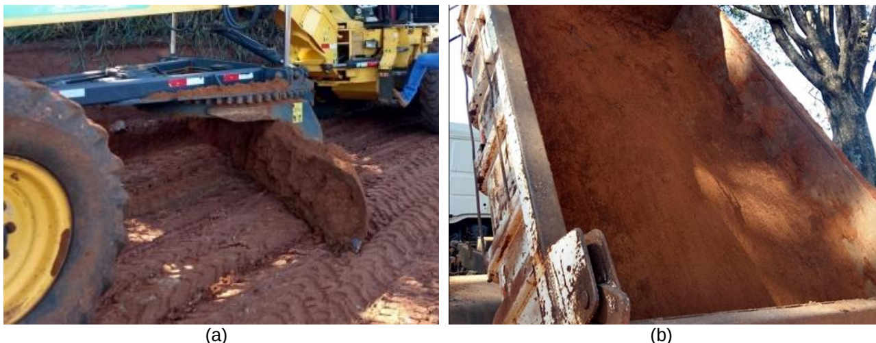
Figura 7 – Efeito embuchamento em pá de motoniveladora operando em estrada vicinal devido a elevada umidade (a), e caçamba de transporte de solo para estrada apresentando material aderido devido a elevada umidade (b).
